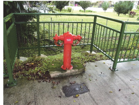
市街の消火栓
