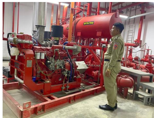
大規模施設の消火設備
