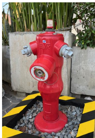
市街地の消火栓
