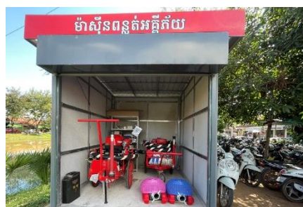
消火ポンプ基地
