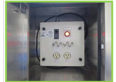
แหล่งจ่ายไฟ
