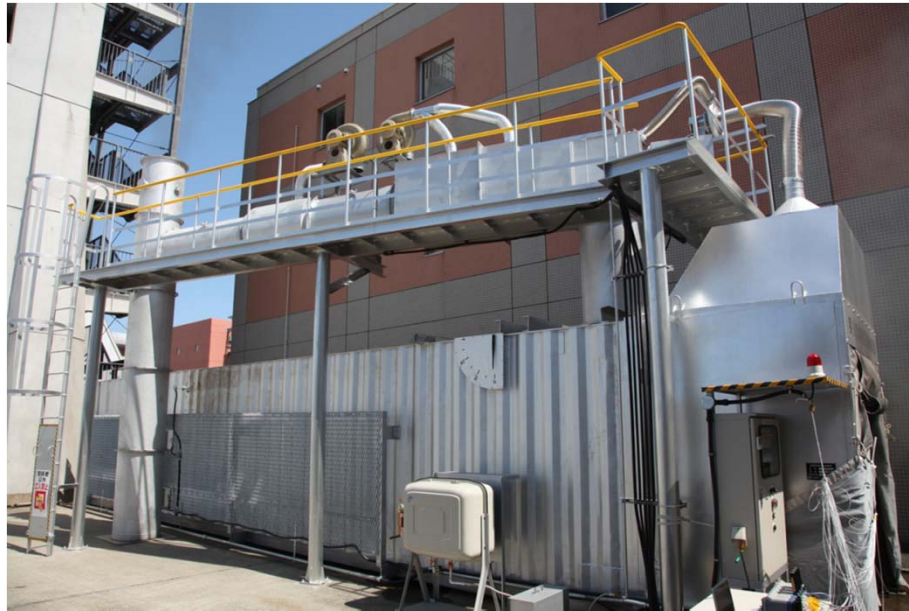
実火災体験型訓練施設
